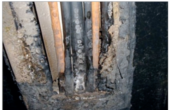
Abbildung 3: Die Kabel nach dem Öffnen einer Kabelvollbandage (nach Brand) /Quelle: Brandschutzchemie BSC/
