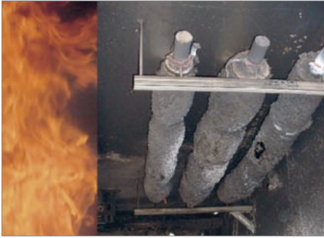
Abbildung 2: Flammenschutz auf Rohrleitungen / Quelle: Brandschutzchemie BSC/
